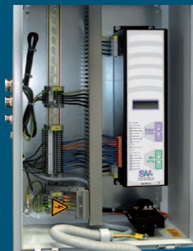
Steuerung im Schaltkasten
