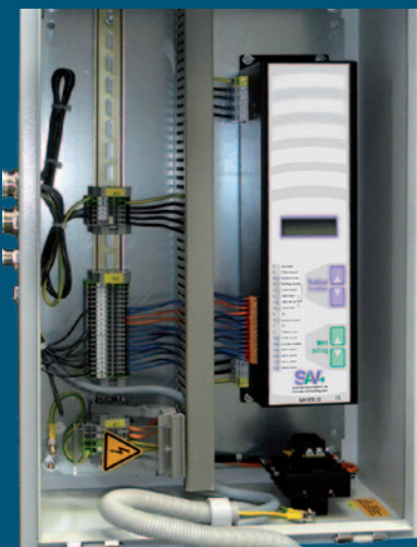
Steuerung im Schaltkasten
